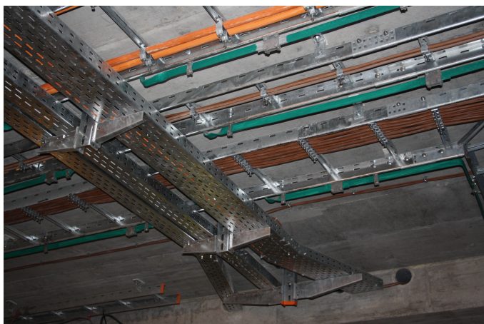
koryta stalowe perforowane i drabiny kablowe
