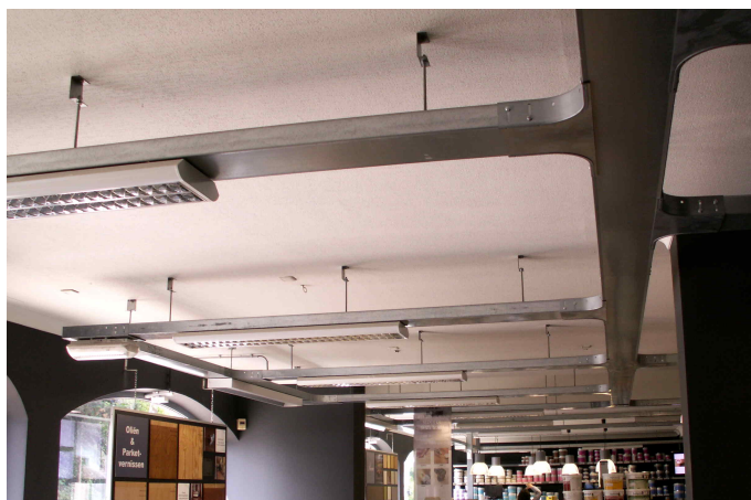
koryta stalowe pełne
